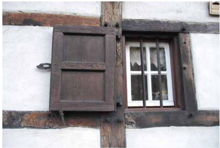
5d 'n Vënsterke (Hellebrook) zit tösje de reëgelsj en is getralied. D'r sjlaag hingt mèt 't gehing in töaldesj. 2016.
